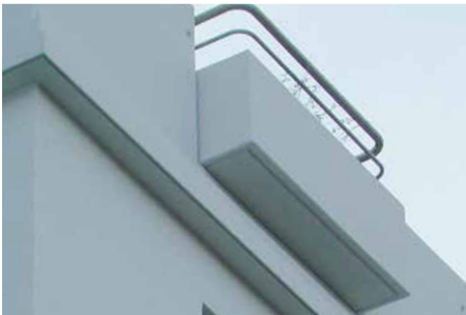
Die grossen Fassadenflächen sind mit einem aufgesetzten StoDeco Profil mit Abtropfkante (Wassernase) vor ablaufendem Schmutzwasser geschützt und zweimal mit StoColor Fungasil gestrichen.
