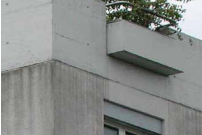
Schlecht gelöste Anschlussdetails und keine Blechabdeckung. Der Schmutz von den Horizontalflächen und aus den Fugen wird mit dem Wasser über den eingefärbten Deckputz gespült. Resultat: starke Verschmutzung und Pilzbildung.
