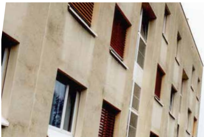
Dieses Gebäude erhielt ein Wärmedämm-Verbundsystem mit einer Isolationsstärke von 100 mm und eingefärbtem Deckputz. Das Bild der algenbefallenen Fassade entstand 4 Jahre später.
